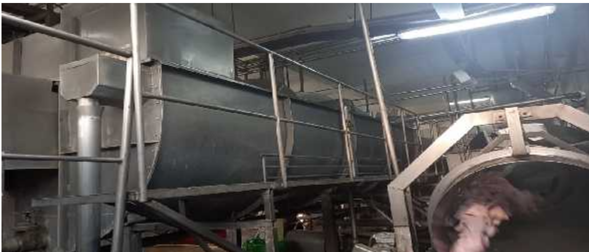
Ilustración 14 Equipos de enfriado: Chillers
