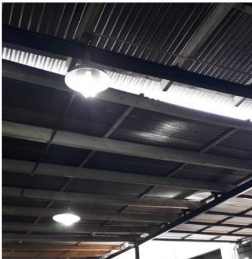
Luces que no se encuentran con protección en el sector de fraccionamiento.
