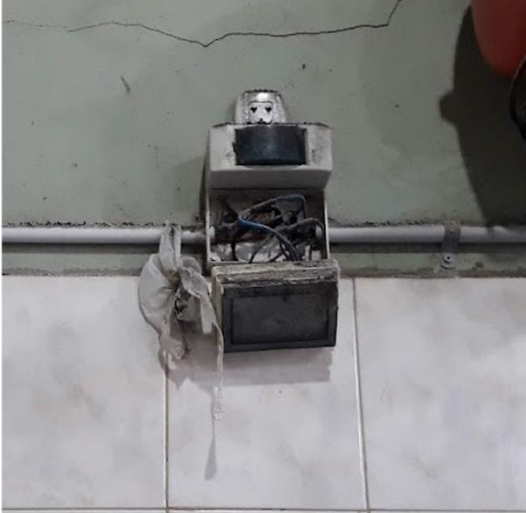
Algunas conexiones de electricidad expuestas en el Est. A.
