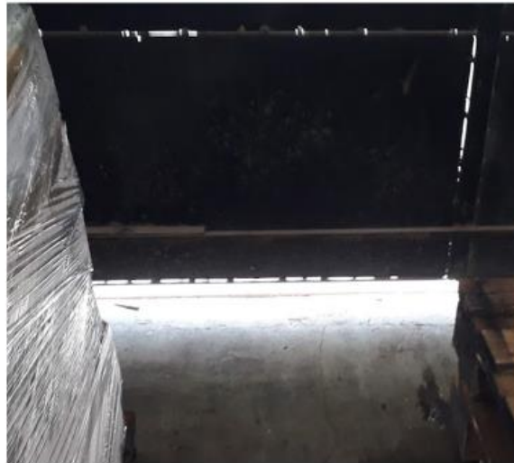
Puertas que comunican hacia el exterior con aberturas que posibilitan el ingreso de plagas
