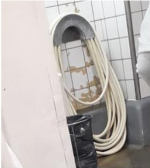
Las mangueras que utilizan para limpiar se encuentran en contacto con el suelo y hay azulejos que no se encuentran en estado.
