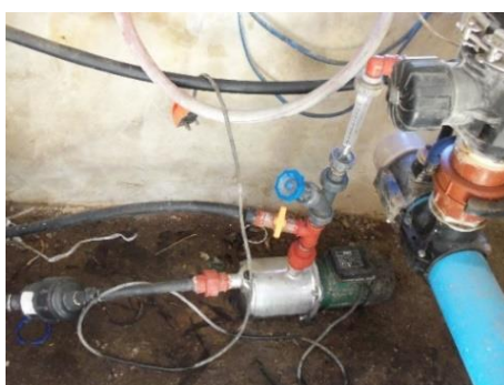
Foto 11. Bomba eléctrica de riego.
